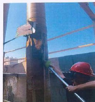
工艺废气排放口 1# DA001
