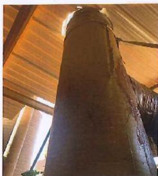
工艺废气排放口 2# DA002
