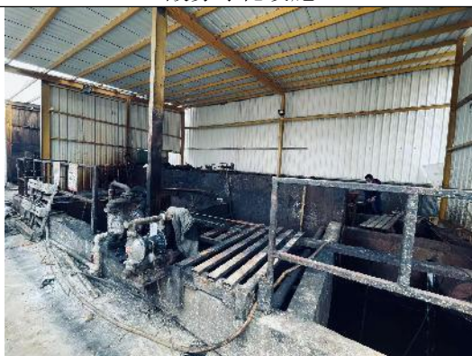
废水治理设施
